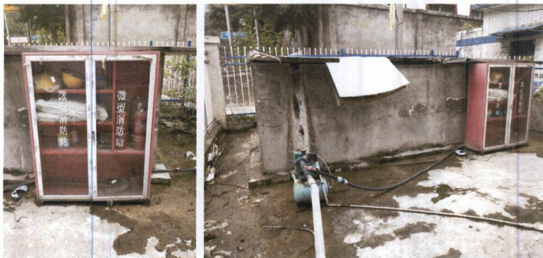
微型消防站和消防水池
